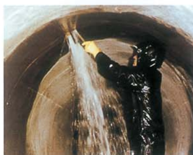
漏水量の多い場合
